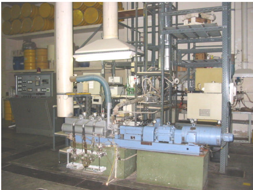
Figura 4.4 Sistema de betuminização piloto instalado no CDTN
