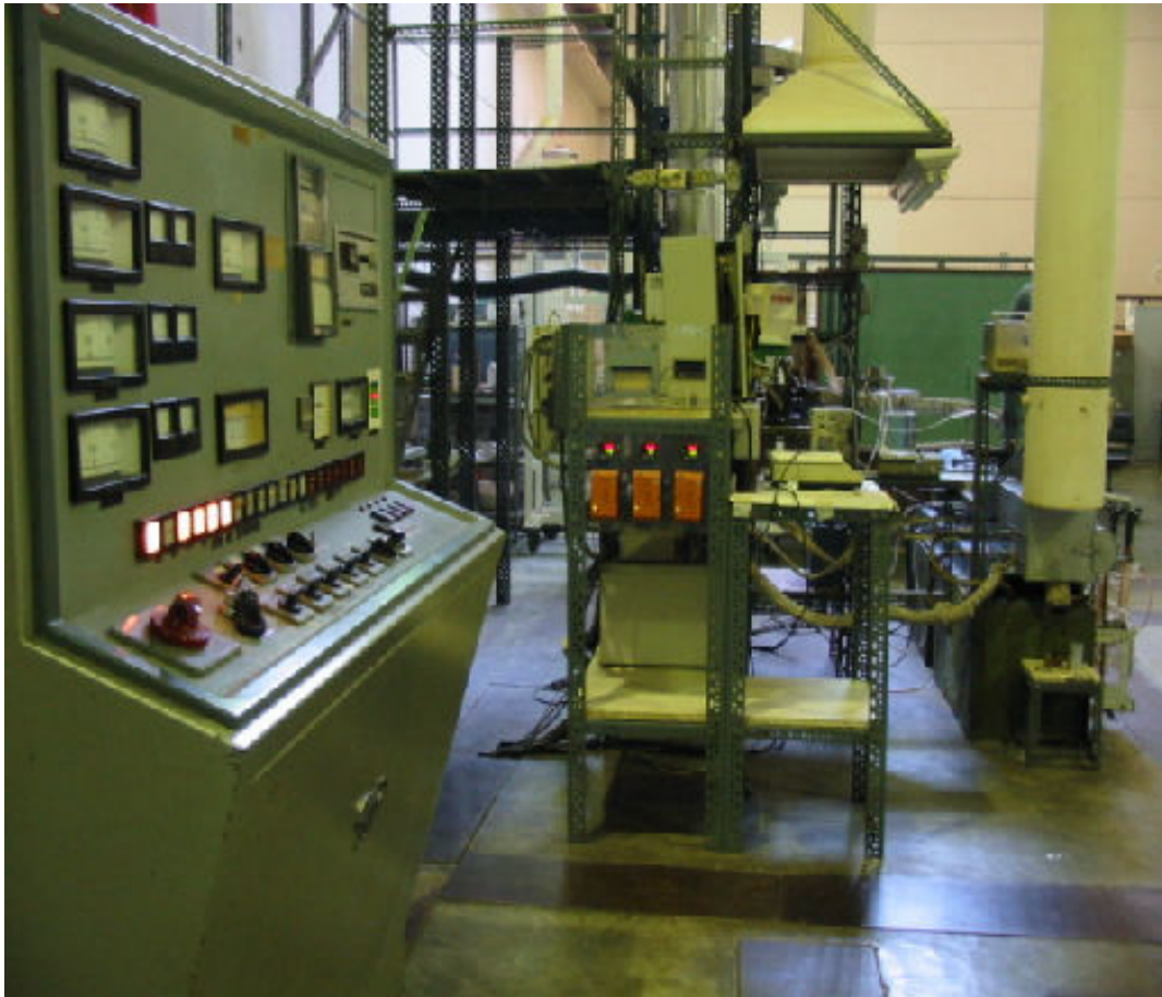
Figura 4.14 Painel de controle do sistema de tratamento de rejeitos
