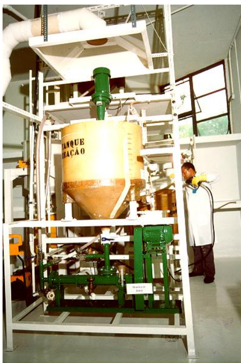
Figura 3.40 - Sistema de precipitação química/filtração do CDTN.
