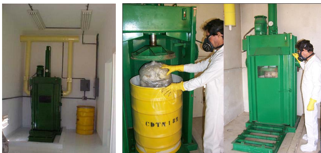
Figura 3.37 - Sistema de compactação de rejeitos radioativos do CDTN.
